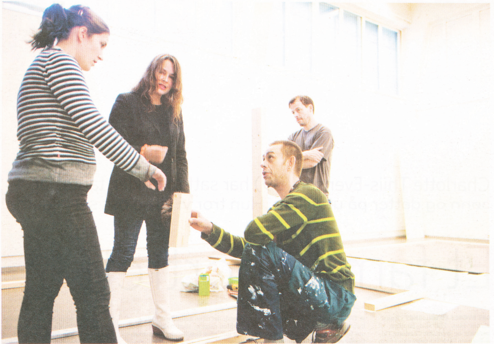
Byggverk: Arkitekt Siri Liset (t.v.) fikk full frihet til å tegne leiligheten som skal huse Thiis-Evensens arbeidere. Her er de halve veggene i ferd med å reises med hjelp av Bertil Sørensen (på huk) og Jonas Eggen. Rommene skal ha forskjellig gulvbelegg og halve vegger og dører.
